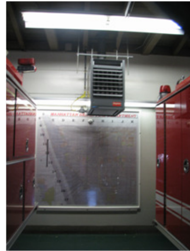
Fire Truck Bay/ Exhaust Fan
